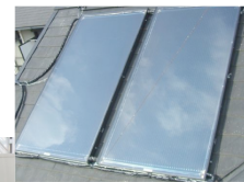
江川次郎宅 家屋根上の 集熱器と、 蓄熱槽
